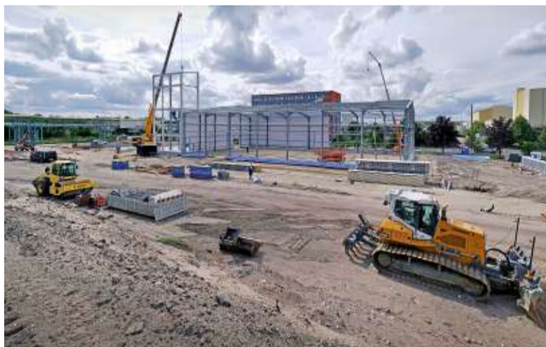
Die neue Anlage wächst Tag für Tag. Mitte September wird Richtfest gefeiert.
